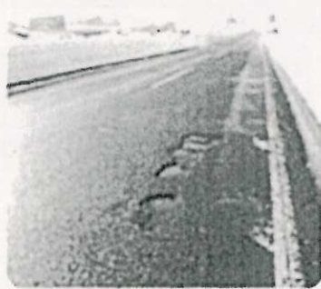
路面の穴ぼこ・ 段差
