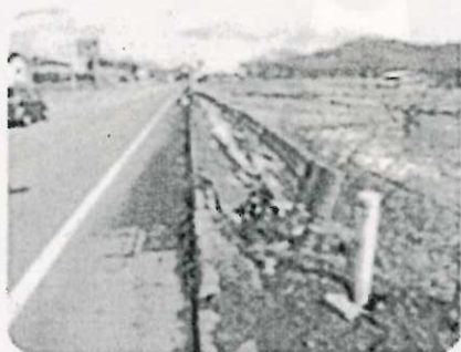
ガードレール・ 標識等の損傷
