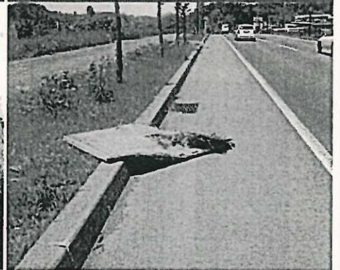
路面の落下物
