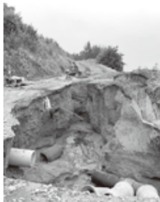
大雨による被害
