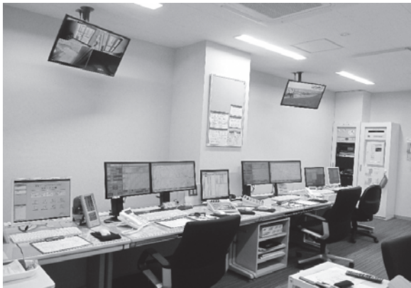
【消防庁舎新築により通信指令室がリニューアルされました】
