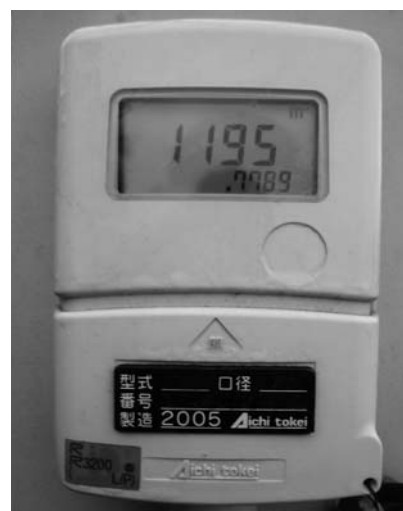
水道メーター
