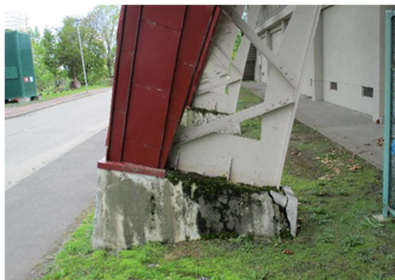
外壁：部分的に劣化（劣化度B）
