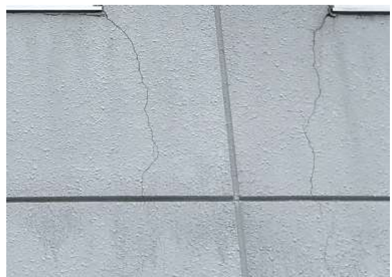
外壁：部分的に劣化（劣化度 B）
