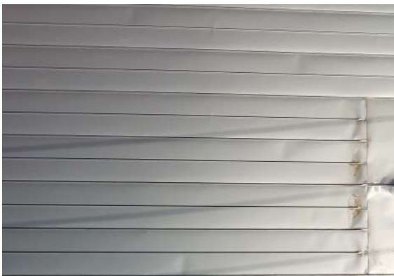
屋根：部分的に劣化（劣化度B）
