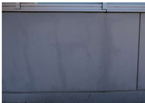
外壁：部分的に劣化（劣化度B）
