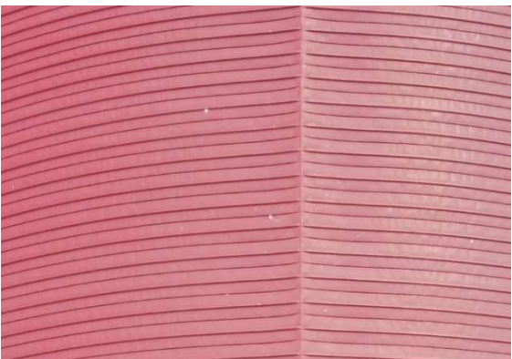
屋根：部分的に劣化（劣化度B）
