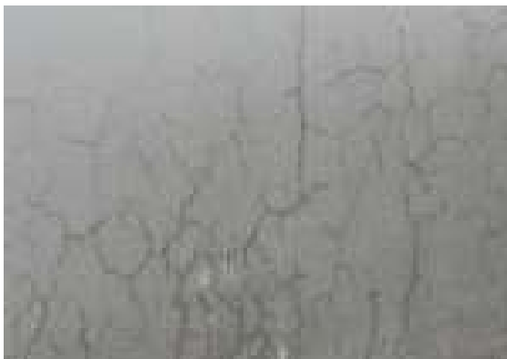
外壁：部分的に劣化（劣化度B）
