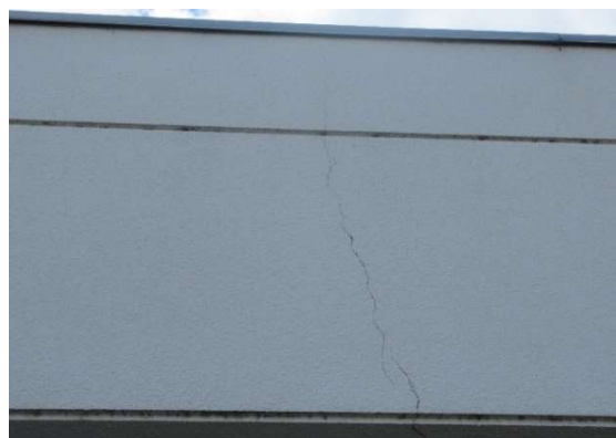
外壁：部分的に劣化（劣化度B）
