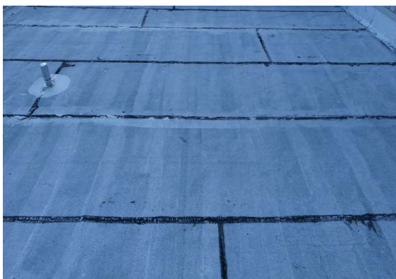
屋根：部分的に劣化（劣化度B）
