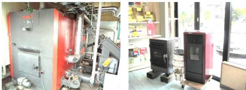
木質ボイラー（峠の湯びほろ／チップボイラー）（左）、木質ペレットストーブ（右）
