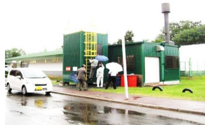
B&G のペレットボイラー外観
