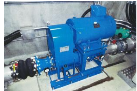
日並浄水場の小水力発電装置
