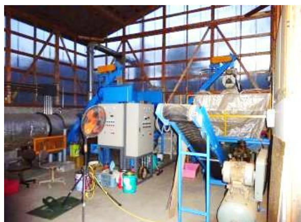
美幌運送（株）のペレット製造施設
