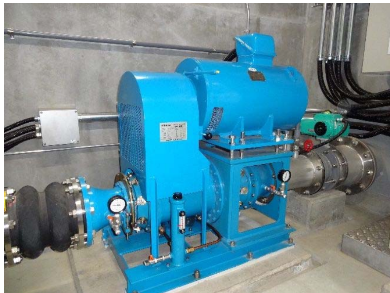
小水力発電機
