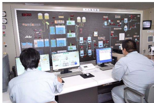
中央監視室 (日並浄水場内)
