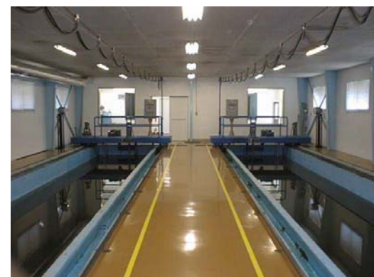
急速ろ過池 (日並浄水場内)
