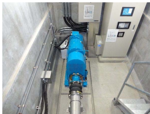
小水力発電機 (日並浄水場内)
