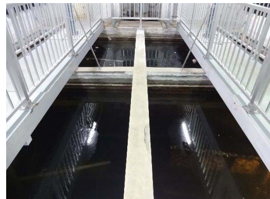
フロック形成池 (日並浄水場内)
