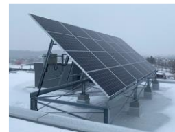
役場庁舎の太陽光パネル
